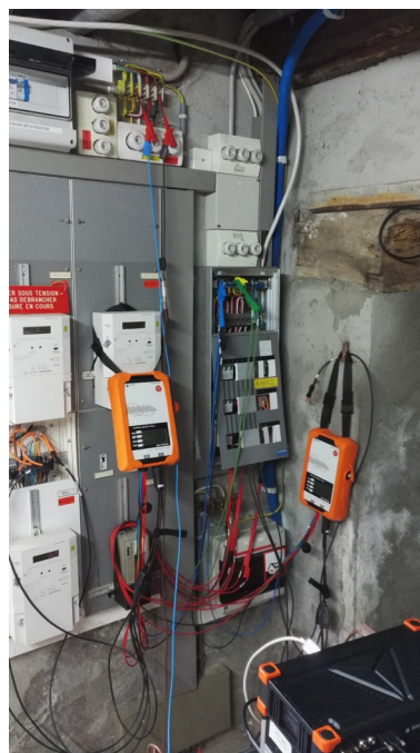
Mesure de terrain sur le réseau basse tension d'Avusy, une commune rurale dans le sud-ouest du canton de Genève. L'alimentation énergétique de deux installations photovoltaïques est mesurée à l'aide de smart meters. Le troisième compteur intelligent mesure la consommation électrique dans la maison. Photo: D. Roggo
